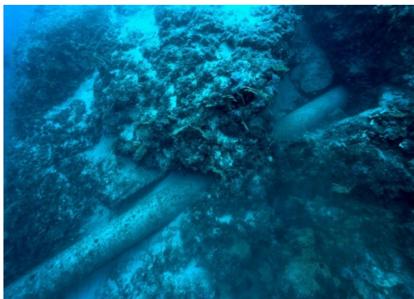
Figure 10 : Illustrations des travaux de réhabilitation de l'émissaire de la Causinière trois ans après leur réalisation. On observe le nouvel émissaire au travers des récifs coralligènes (Source : Andromède Océanologie, 2010). Le forage du coralligène a permis d'éviter la destruction des herbiers à posidonie qui sont observés entre -28 m et -6 m sur la zone.
