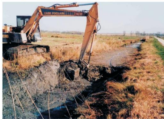
Figure 2 : Creusement d'un fossé atterri par curage afin de restaurer sa fonction hydraulique (Source : Forum des marais atlantiques)
